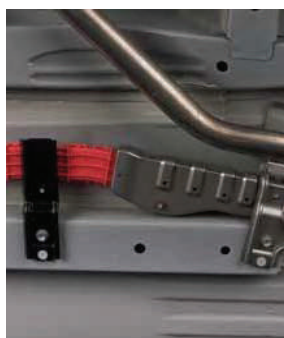
Blindagem térmica junto do escape quente
