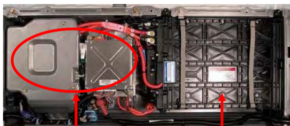
Inne elementy wysokonapięciowe
