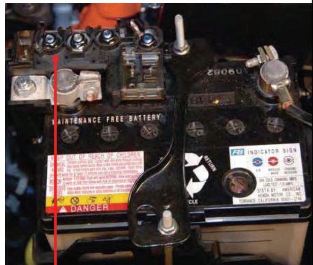
Aansluiting omvormerkabel DC naar DC
