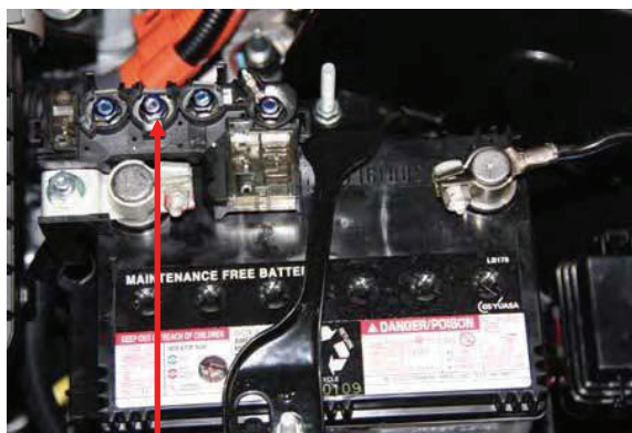
DC til DC-omformer, kabeltilkobling
