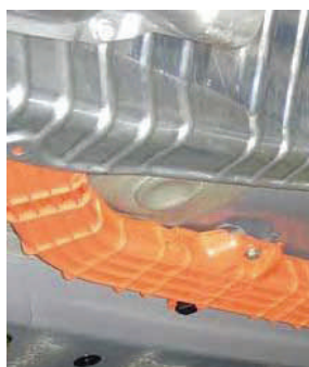
Protezione elettrica imbullonata al sottoscocca
