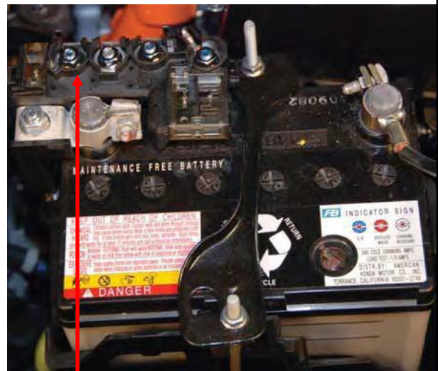
DC-DC konverter kábele
