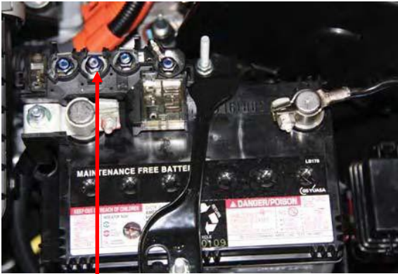
DC-DC konverter kábelének csatlakozása
