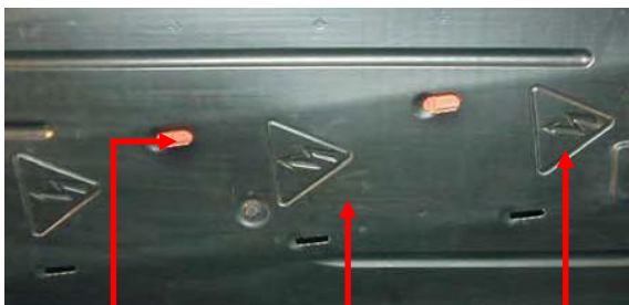
Ορατό καλώδιο υψηλής τάσης
