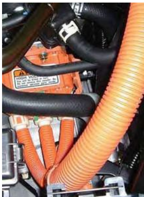
Σύνδεση καλωδίου υψηλής τάσης στο μοτέρ
