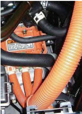
Hochspannungs- Kabelverbindung zum Motor
